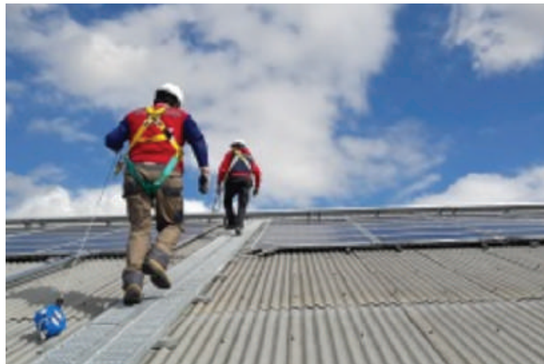
Ilustración 17 Ejemplo de medidas de seguridad para protección contra caídas (Fuente: Ministerio de Energía)
