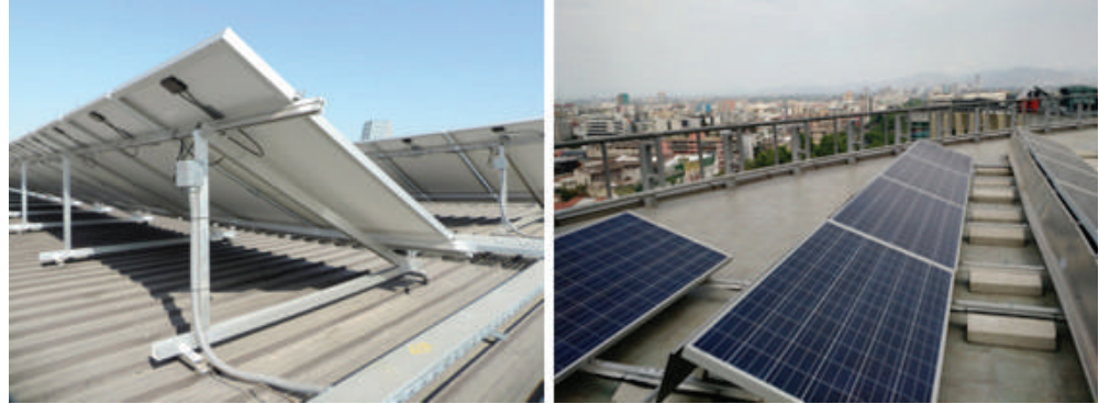
Ilustración 4 Estructura de soporte de módulos fotovoltaicos inclinados. Izquierda: Planta Fotovoltaica Edificio GAM. Derecha: Planta Fotovoltaica lastrada en Ministerio de Energía (Fuente: Ministerio de Energía)
