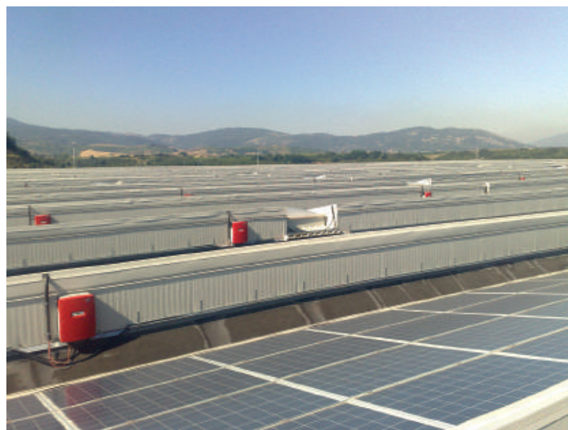
Ilustración 27 Inversores desprotegidos del efecto de radiación solar directa (Fuente: DGS Berlin e. V.)
