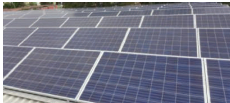
Ilustración 2 Ejemplo módulos en un sistema FV, Teletón Santiago (Fuente: Ministerio de Energía)
