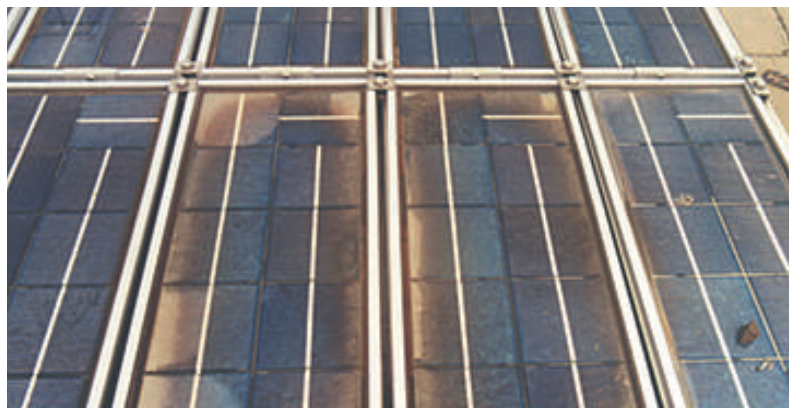
Ilustración 33 Módulo fotovoltaico afectado por decoloración, lo que causa una reducción del rendimiento (Fuente: DGS Berlin e. V.)
