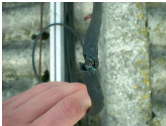
Ilustración 48 Aislamiento del cable defectuoso por roedor (Fuente: DGS Berlin e. V.)
