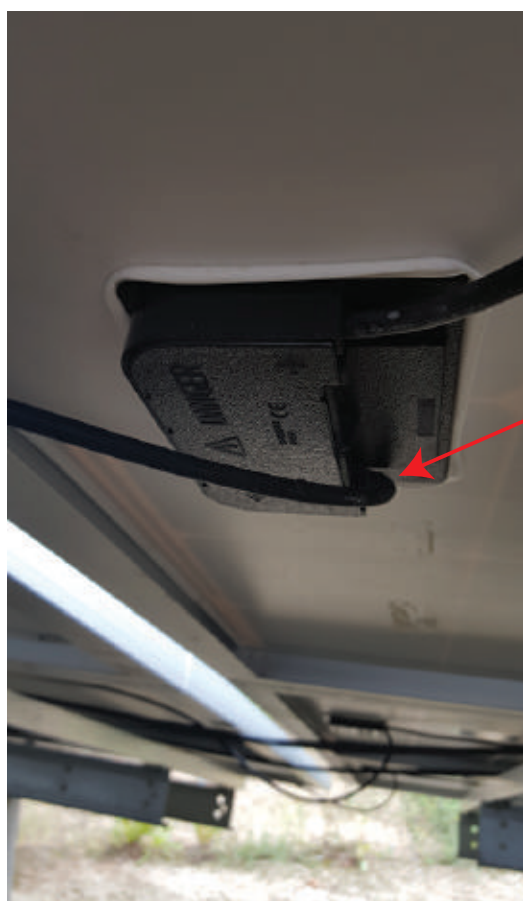
Ilustración 50 Radio de curvatura del cable insuficiente (Fuente: DGS Berlin e. V.)
