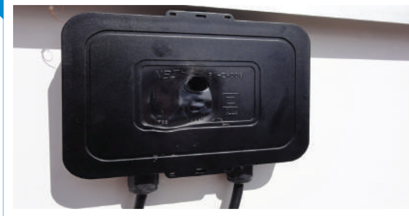
Ilustración 38 Caja de conexión quemada por conexión interna defectuosa (Fuente: DGS Berlin e. V.)
